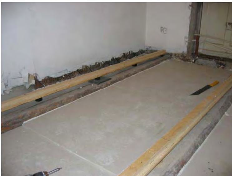
Konstruktion med svingningsdæmpere, der ses som oplodsning under brættet langs væggen
