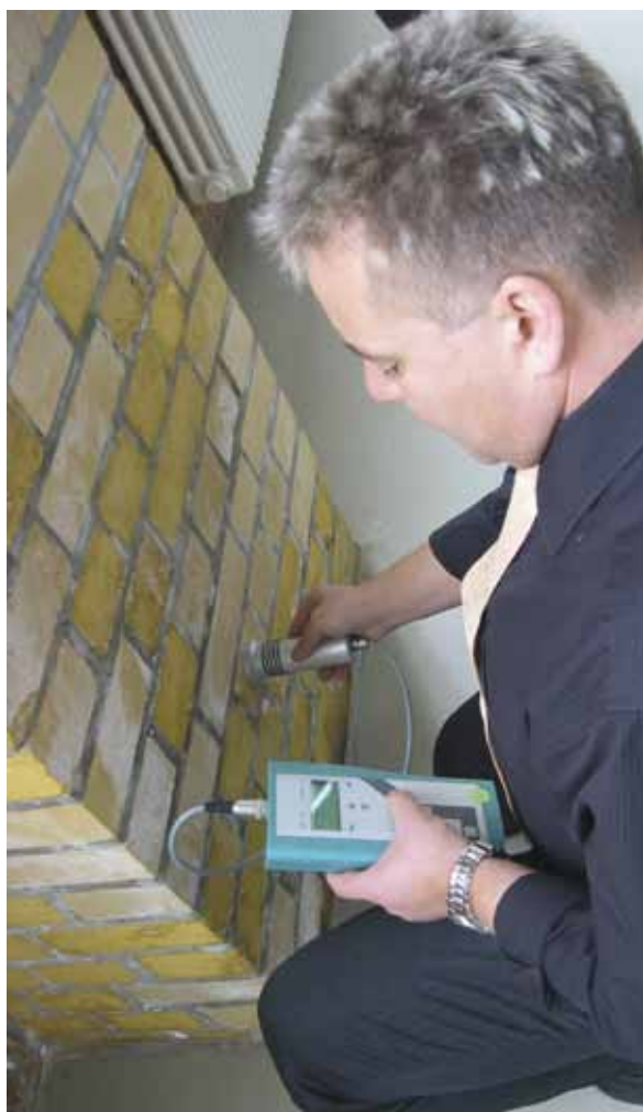
Fugtmåling med HF sensor metoden (mikrobølgerefleksion)
