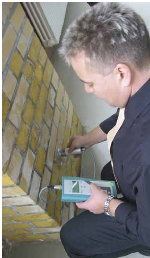
Fugtmåling med HF sensor metoden (mikrobølgerefleksion)
