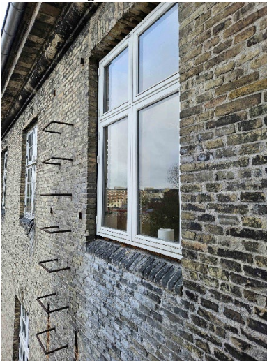
Nærdetalje af facaden hvor der ses skader under vinduet. Muren var gennemgået inden efterisoleringen og den var vurderet til at være i god stand og derfor blev den ikke repareret.
