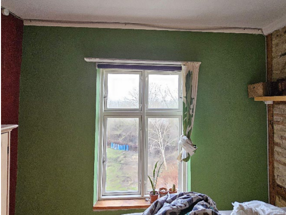
Den indvendige overflade af den efterisolerede væg virkede fin. Der var installeret en vinduesplade senere. Indeklimaet virkede indelukket.
