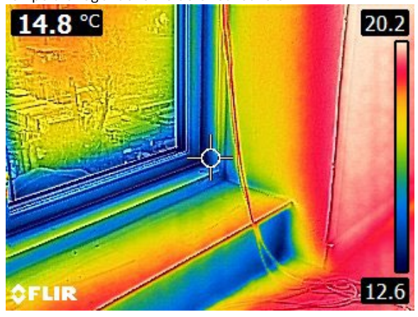
Termografibilledet viser effekten af isoleringen i lysningen.
