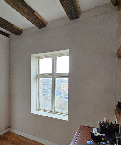
Overfladen af de efterisolerede vægge var helt uden skader. Indeklimaet virkede indelukket
