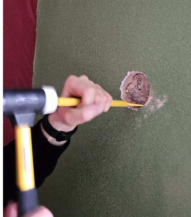
Udhugning af limmørtel. Der var ikke noget puds på den indvendige side af murværket.
