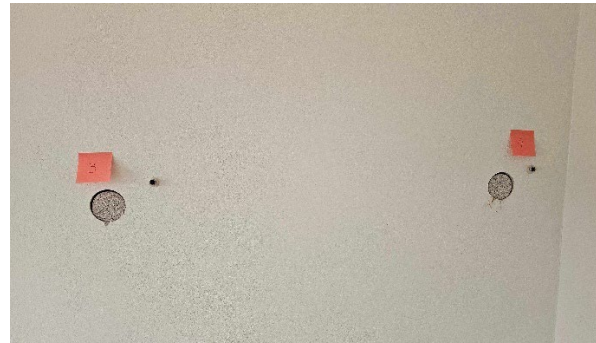
Illustration af placering af prøvekerner samt Rotronic måling af temperatur- og relativ fugtighed bag isoleringen.
