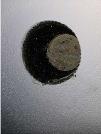
Borehullet viser murværket.
