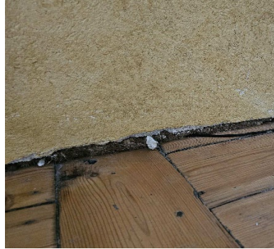
Den indvendige overflade af de efterisolerede vægge var fin, med enkelte små huller fra ophængning af billeder og lamper. Isolering og puds var ikke rigtig afsluttet mod gulv.
