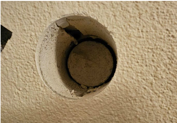
Borehullet afslørede at isoleringspladerne ikke var monteret med kontakt til hinanden.
