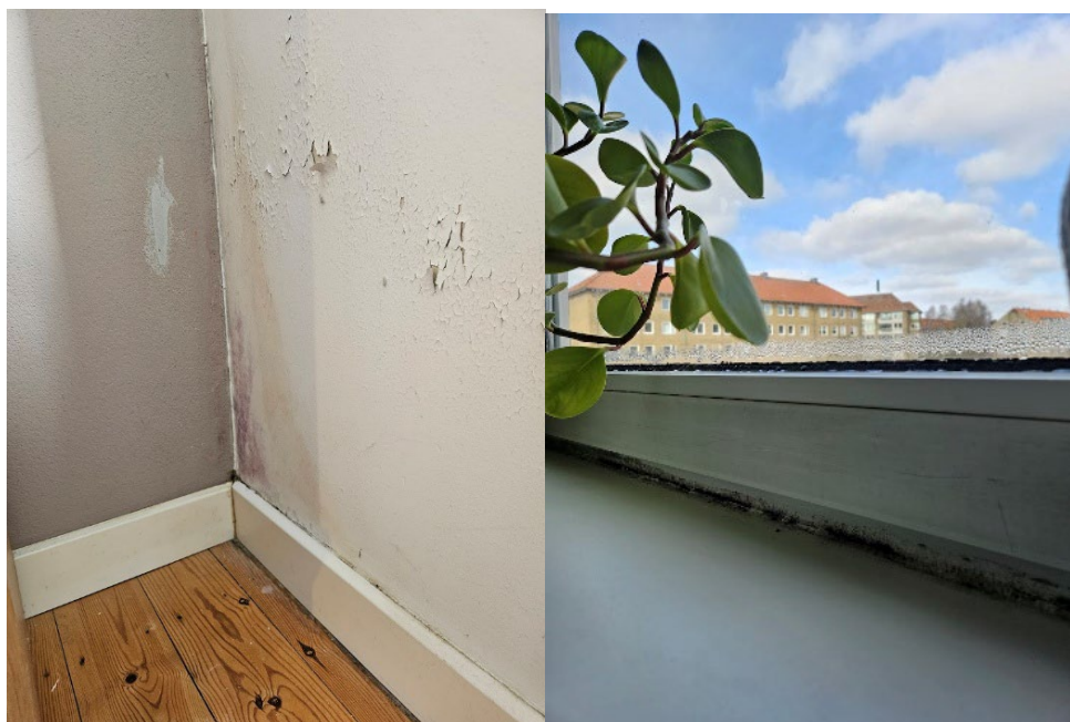
FIGUR 30. a) Billedet viser et koldt hjørne, hvor den efterisolerede gavlvæg til venstre møder uisoleret facadevæg til højre. Der er tydelige tegn af afvasket skimmelvækst samt afskalninger på den uisolerede væg. b) Indeklimaet i denne lejlighed virkede meget varmt og fugtigt. Billedet viser dug på vinduet og sort skimmelvækst langs vinduesrammer.
