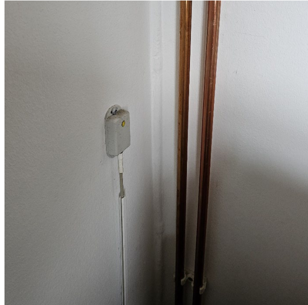
Den faste indeklimasensor var placeret ca 10 cm fra et varmt radiatorrør.
