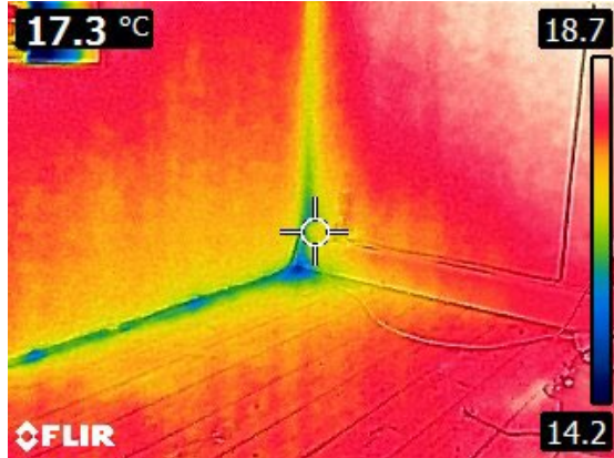
Termografi viser kolde overflader i kanten af væggen.
