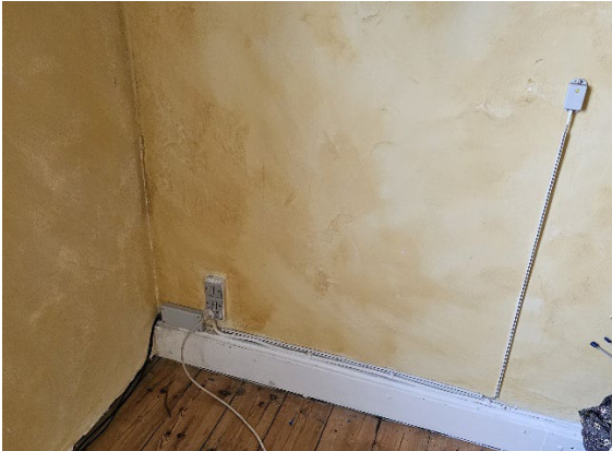
Den faste indeklimaføler er monteret på skillevæggen.
