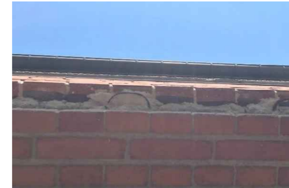
Figur 43 Hjørne ved underkant af brystningsmur og loft kan være kritisk. Her ses rust i armering, som forbinder betonplade til mursten i hjørne.
