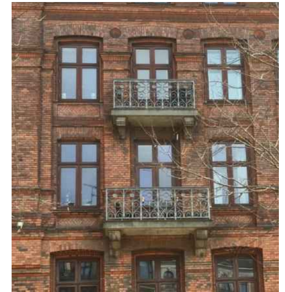
Figur 7 Ofte ses ved betonplader, at der er udført decorationer af puds af cementmørtel på undersiden af altanen – en slags pyntekonsol. NB : Cementpudsen må ikke forveksles med beton. Pudsen har dekorative formål, betonen er bærende.
