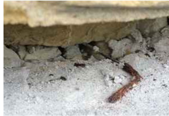
Figur 47 Korrosion af murbinder i hulmur.
