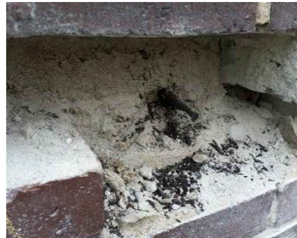
Figur 48 Korrosionsprodukter viser sig som rustflager.
