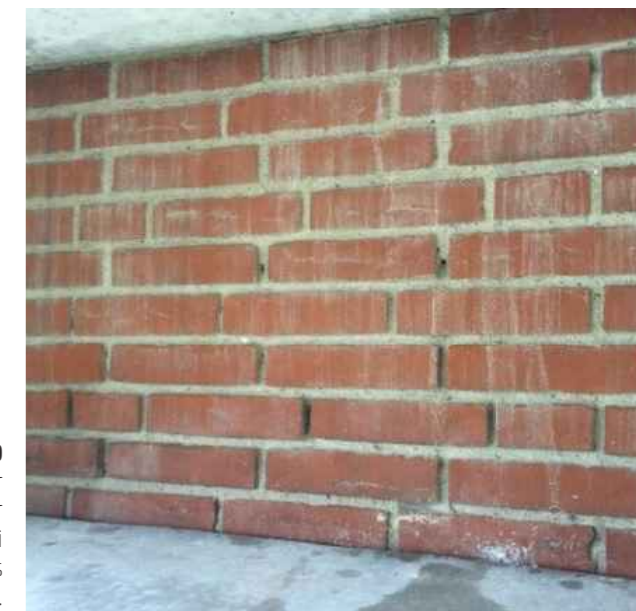
Figur 40 Underside af altangang i beton, hvor overfladevand og salte er ledt til murværket. Den visuelle tilstand af murværket giver her en indikation af, at betonen kan være saltbelastet, og det vil i dette tilfælde være en god ide at få udført en analyse af betonens chloridindhold samt at få vurderet armeringens tilstand nærmere.
