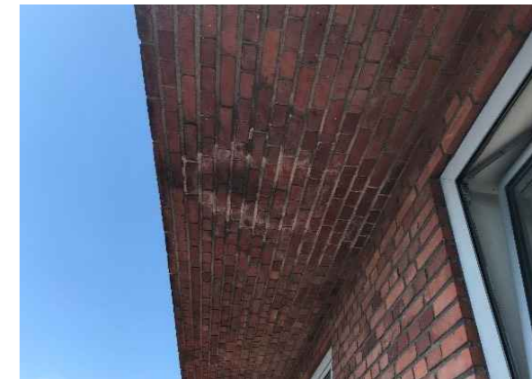
Figur 45 Misfarvning af murværk kan skyldes gennemsvivning af vand.
