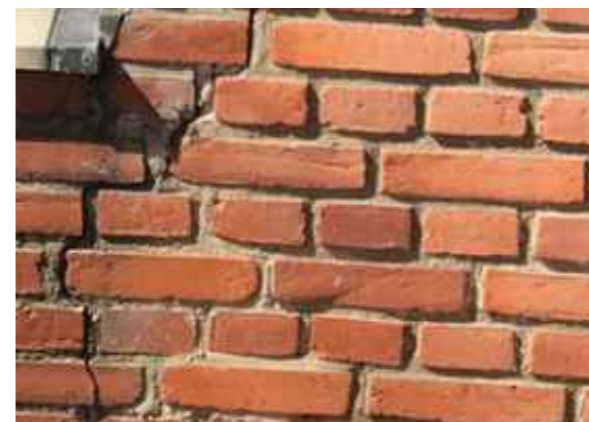
Figur 44 Subparallel revnedannelse i facademurværket undersøges ved bankning/prøveudtagning. Evt. murbinderes tilstand bør undersøges.
