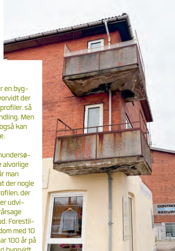
↑ En tilfældig bygning, hvor det bærende stål er blottet, og hvor korrosion er fremskreden. Handling er påkrævet
