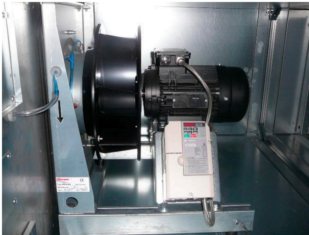
Figur 334. Ventilator med variabel hastighedsregulering
