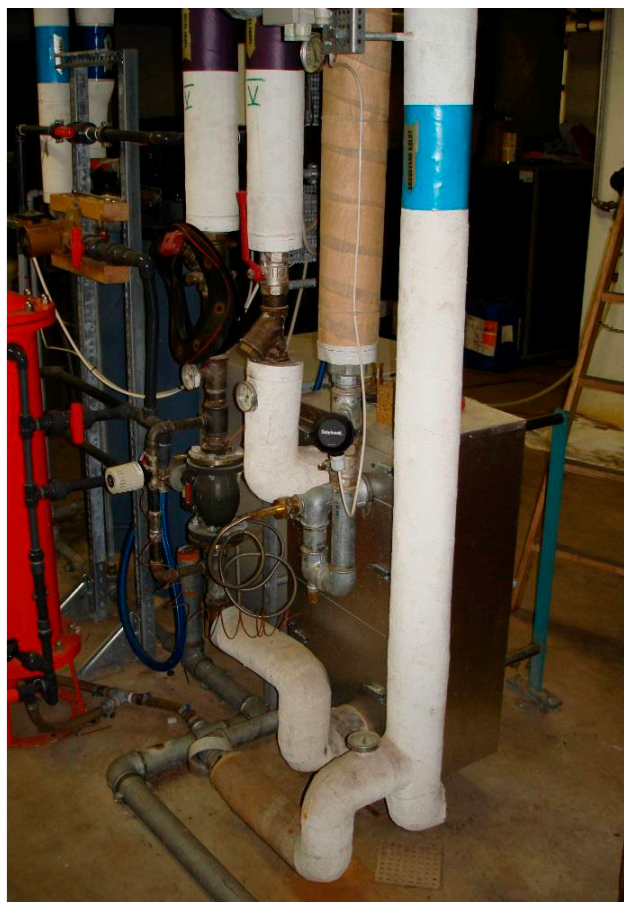
Figur 2. Gennemstrømningsvandvarmer i varme-central
