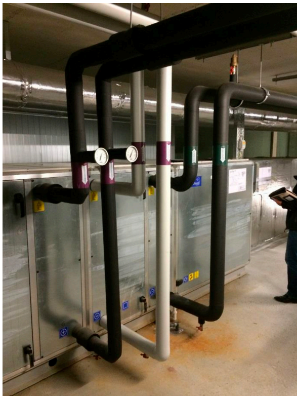
Figur 7. Ventilationsanlæg med køleflade der tilføres koldt vand
