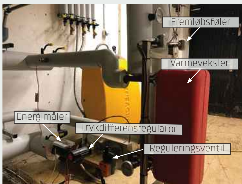
Figur 3 – Indirekte anlæg (med varmeveksler). Regulatoren er ikke vist på billedet. I dette tilfælde kan varmekurven indstilles fra CTS anlægget.
