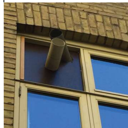
EKSISTERENDE AFKAST FRA EMHÆTTER I KARREÉN HVOR DER IKKE ER AFTRÆKSKANALER I KØKKEN
