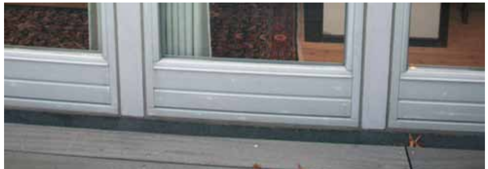
Lavsiddende dørparti i indbygget altan – risiko for vandindtrængen
