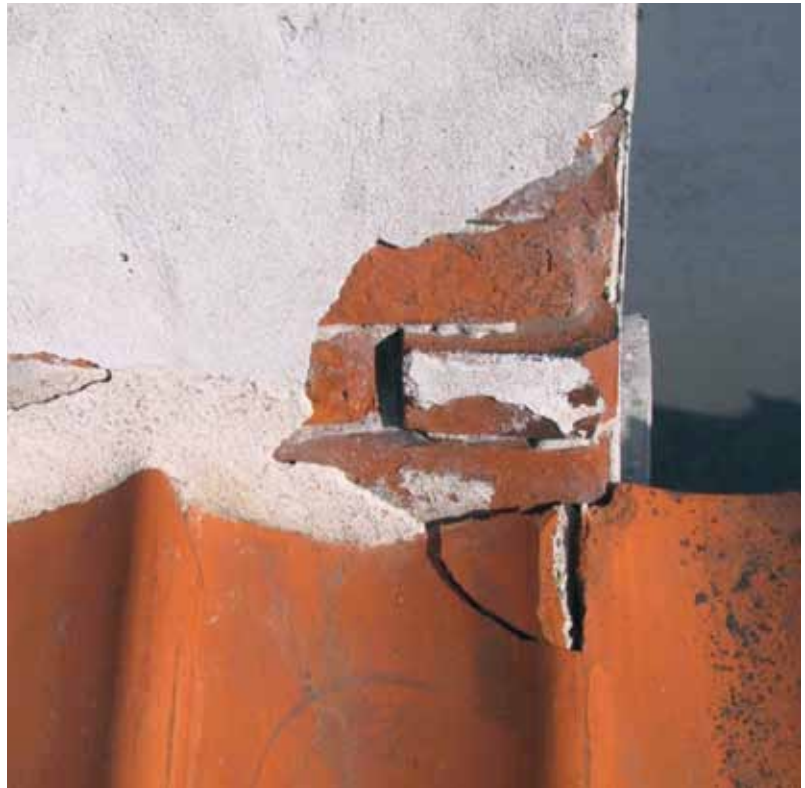
Skade ved skorsten
