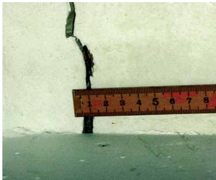
Kritisk sætning i kældermur
