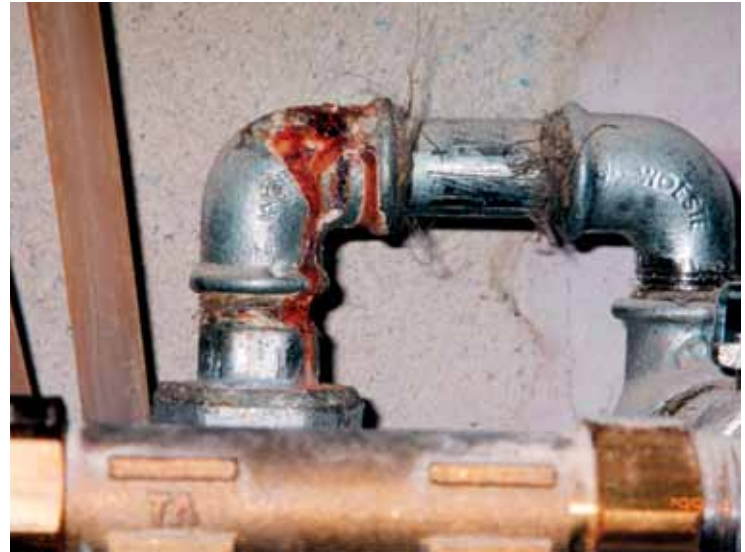
Tæringsskade på galvaniseret stålrør
