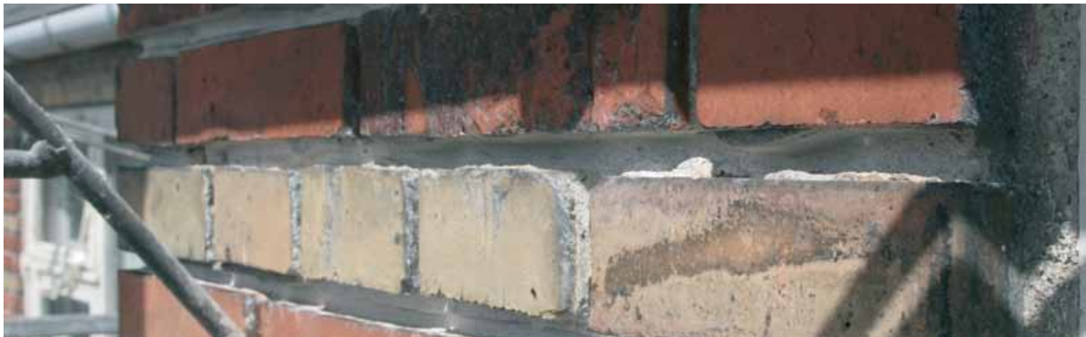
Gammelt murværk med udvaskede fuger
