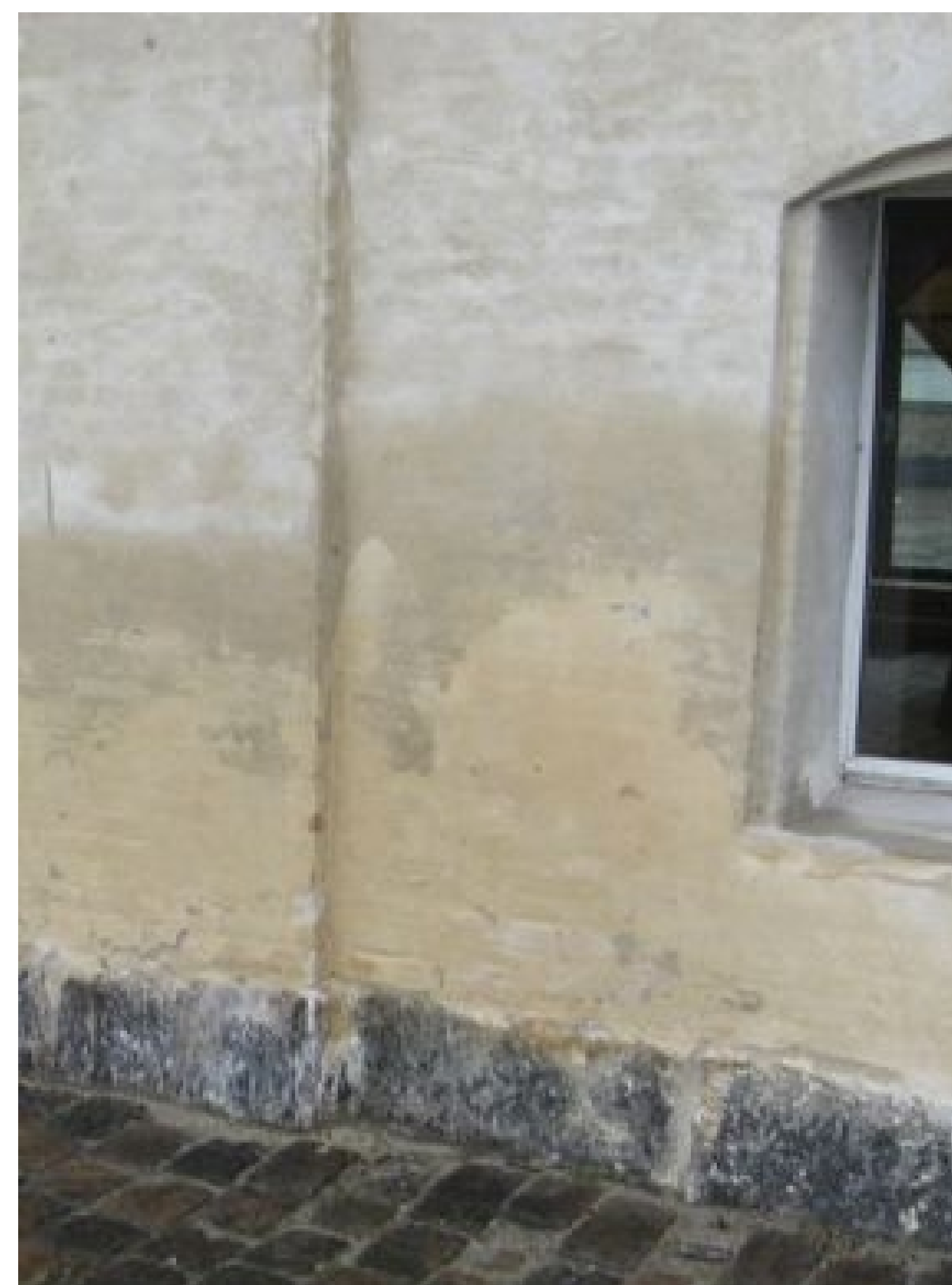
Figur 1. Fugtigt murværk – et problem uden nem løsning
