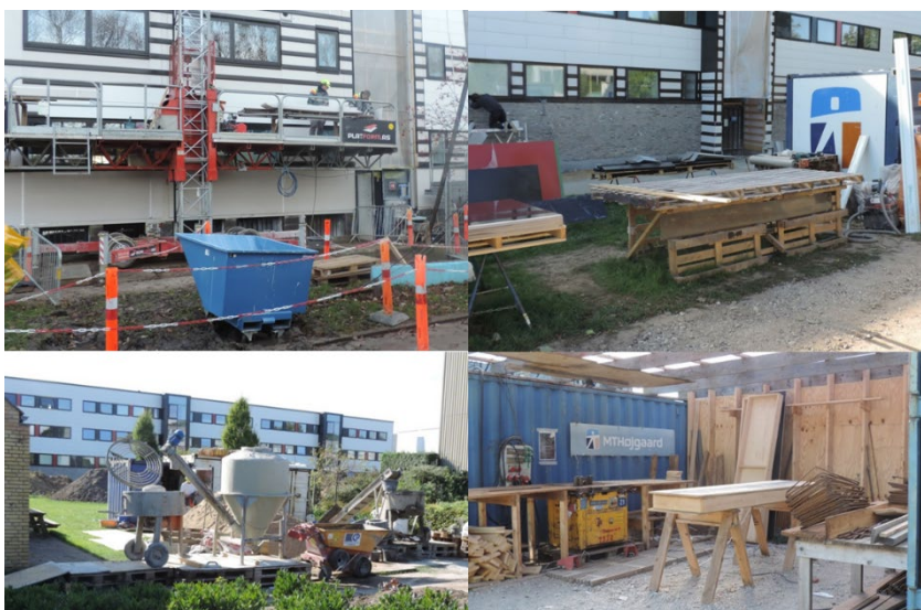
FIGUR 16. Eksempler på forskellige arbejdsstationer på byggeplads til renovering af en almen boligbebyggelse i Aarhus. Her bearbejder byggesjak og fagentreprenører materialer og byggevarer, inden de kan montere dem på den enkelte bygningsdel og gentagelse. I øverste venstre billede er vist flytbar arbejdsplatform til renovering af facadeafsnit. I øverste højre billede er vist flytbart tilskæringsbord foran indgang. I nederste venstre billede er vist flytbar betonblandestation mellem 2 boligblokke. I nederste højre billede er vist fast bukkestation for armeringsjern på fælles lagerplads, som ikke flyttes.
