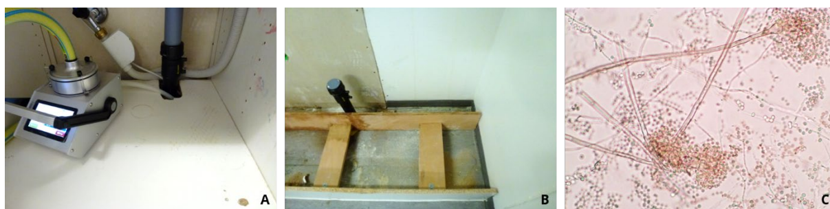
Figur 6. Luftprøve taget i soklen under vaskeskab (A), sokkel med fugtskjolder ved afløb efter nedtagning af skabe (B), tapeaftryk af krydsfiner ved afløb med Aspergillus flavus sporestande (C).
